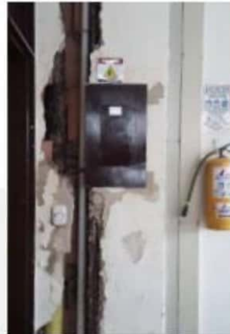
[15] Tubería red eléctrica
