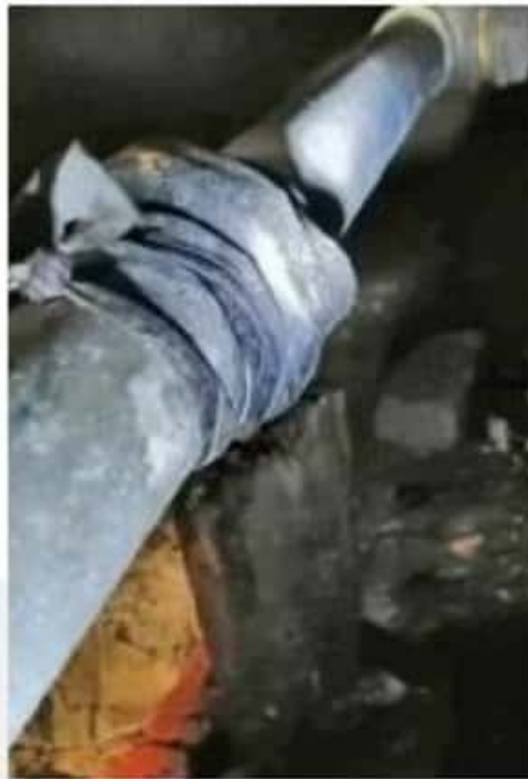
[5] Tubería piscina - Calle 72
