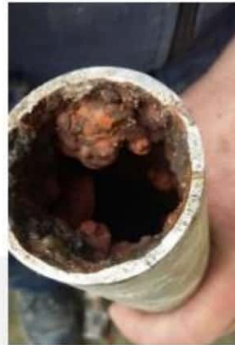
[6] Tubería piscina - Calle 72
