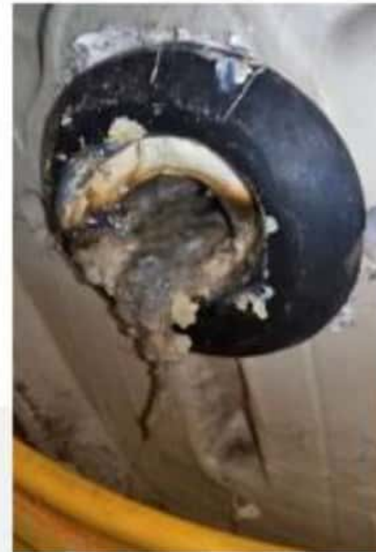
[12] Salidas sanitarias obstruidas por deterioro
