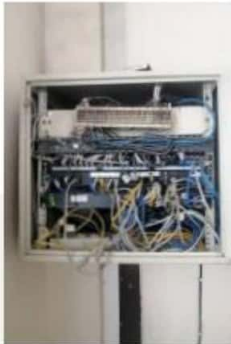
[14] Rack red eléctrica
