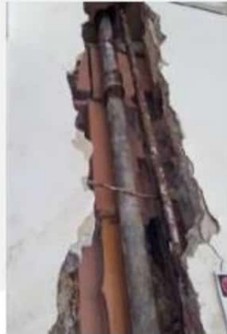
[13] Tubería obsoleta en hierro colado
