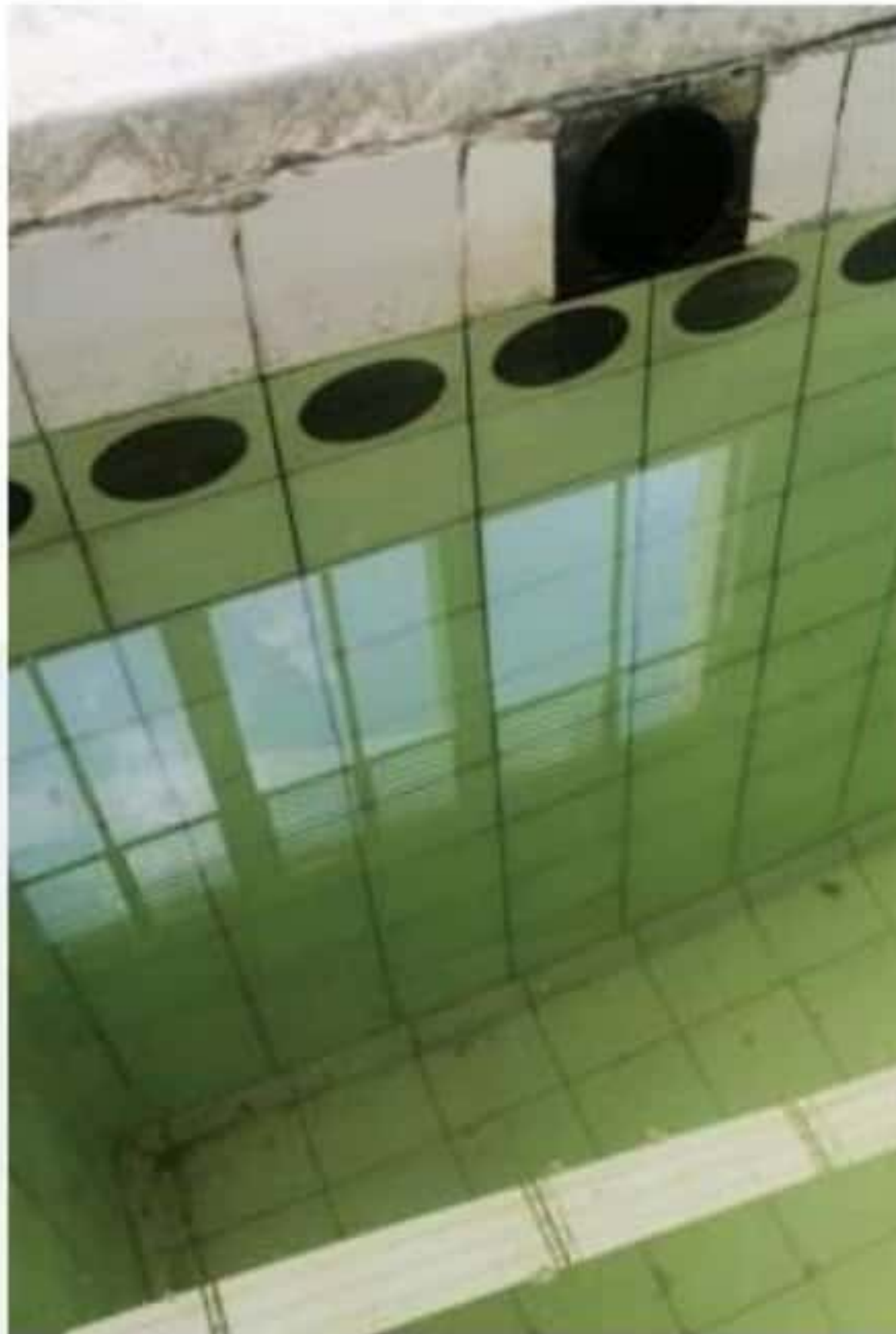
[11] Rejilla en piscina - Calle 72
